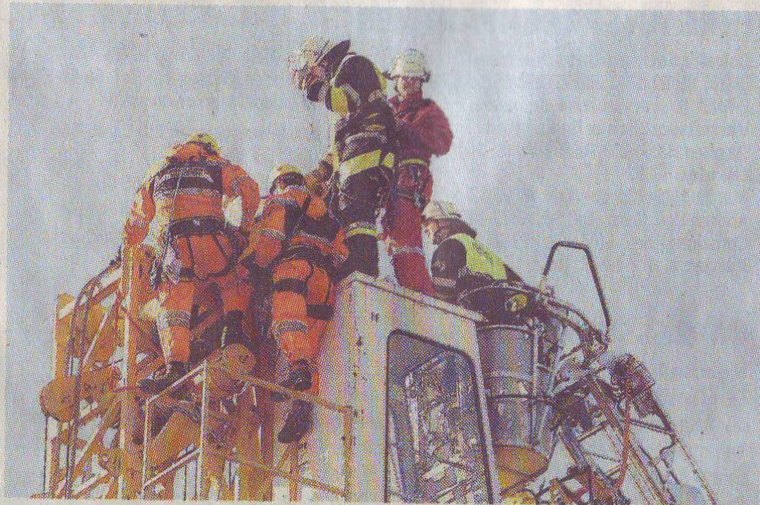
Feuerwehrleute und Rettungsdienst retten den eingeklemmten Kranmonteur aus seiner misslichen Lage. FOTO: JÜRGEN BOLLIG
